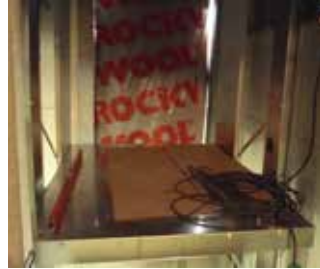
Risiko for å falle fra innsiden av heisstolen når man blir utsatt for fallrisiko.
