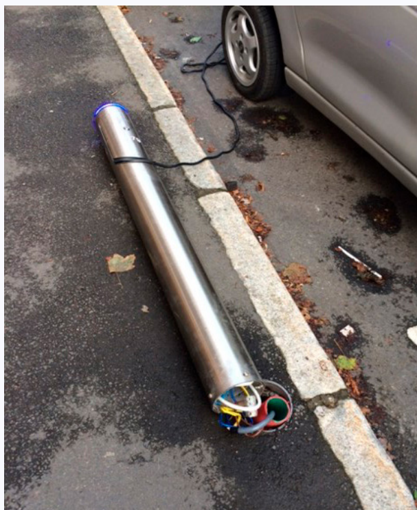
Hvor plassering av ladestolpe kan være utsatt for påkjørsel bør det monteres beskyttelse.
